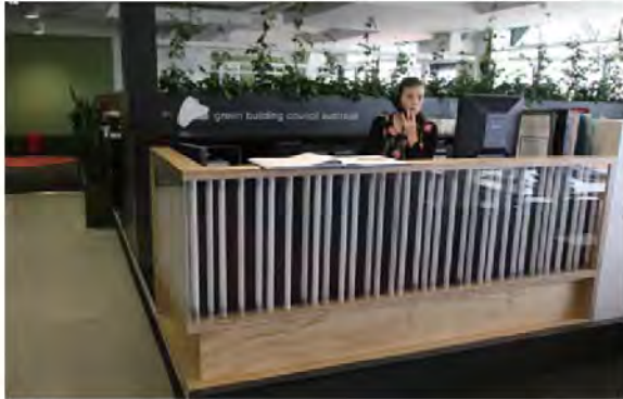
图 4 安装在接待厅置换风口
